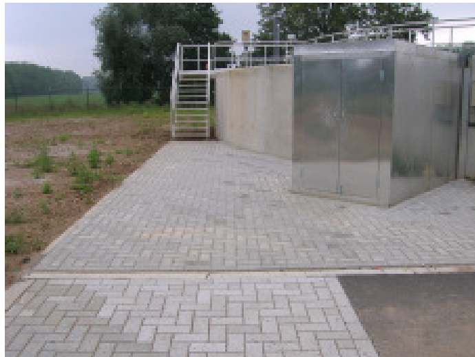
Drijfslagpomp in isolerende omkasting
